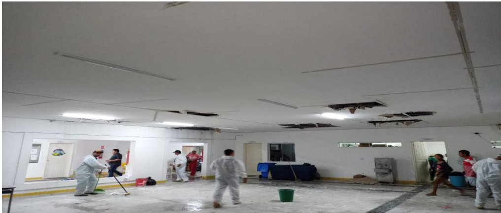
Foto 03 – Desabamento de forro drywall.
