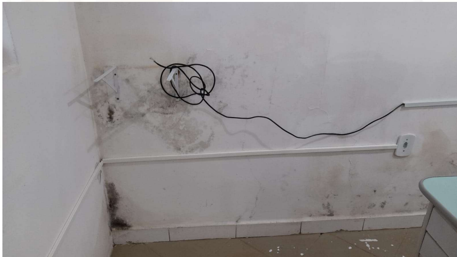
Foto 02 – Umidade na Alvenaria com fungos
