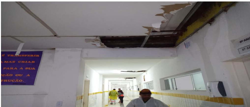
Foto 04 – Desabamento de forro drywall.
