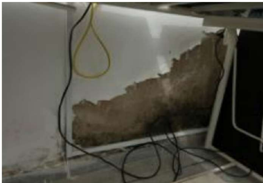
Figura 08 – Vista da parede com o reboco largando pela umidade.
