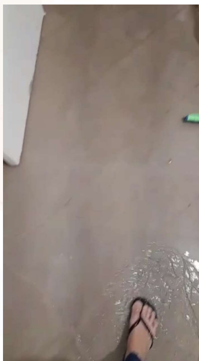
Foto 08 – Infiltrações de água da chuva causado pelo deslocamento das telhas
