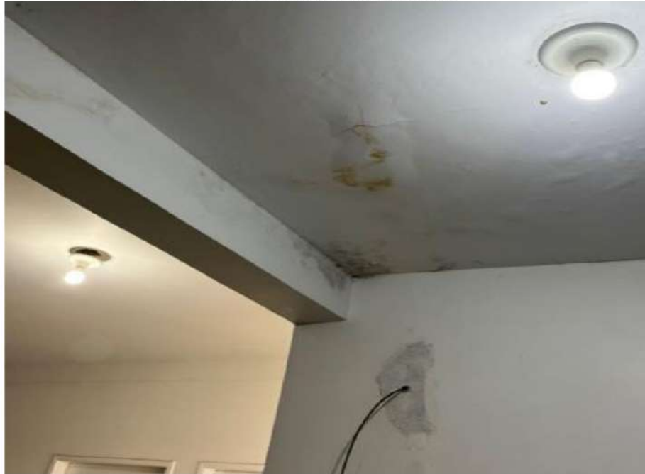
Figura 09 – vista de infiltração no teto.
