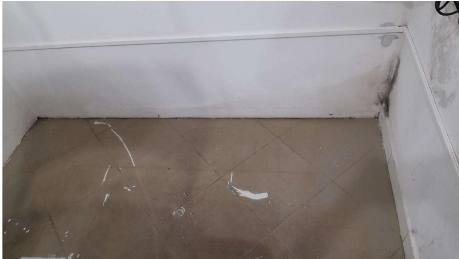
Foto 03 – Umidade na Alvenaria com fungos
