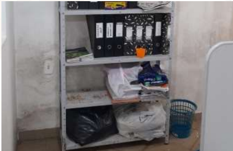
Foto 04 – Umidade na Alvenaria com fungos
