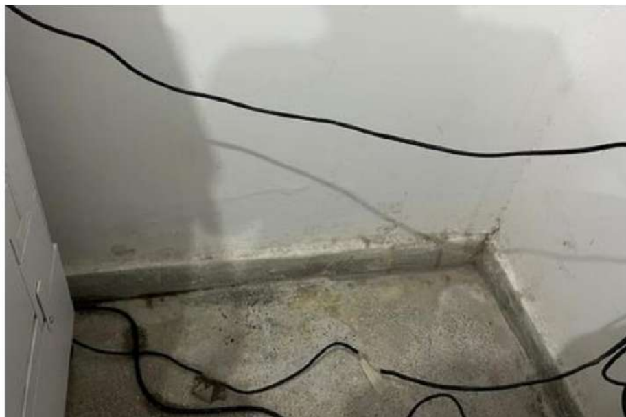
Foto 02 – vista de umidade na parede.
