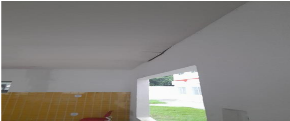
Foto 04 – Infiltração no forro.
