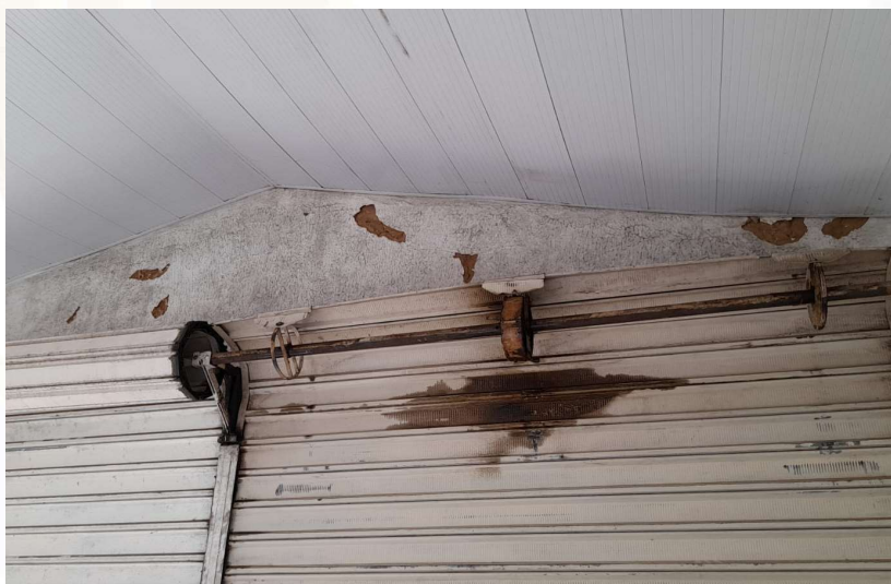
Foto 06 – Infiltrações nas Alvenarias
