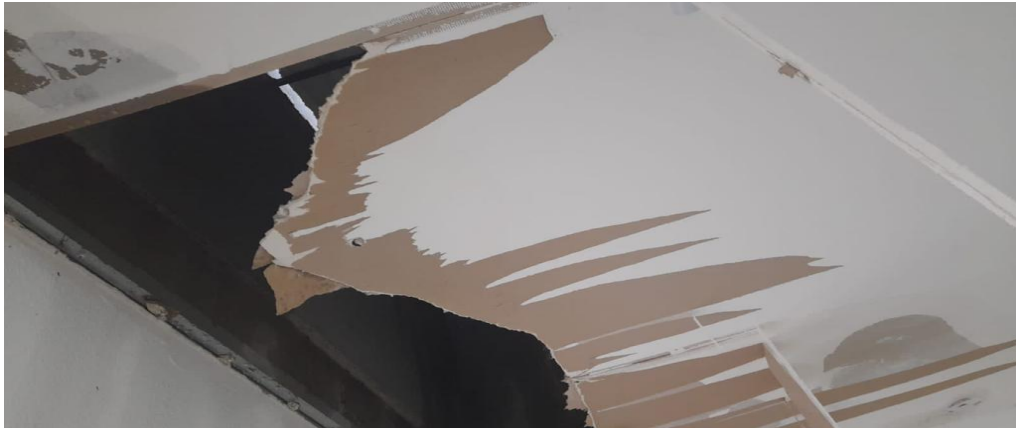
Foto 01 – Desabamento de forro drywall.
