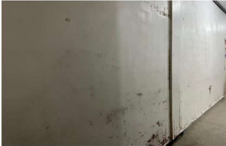
Figura 11 – vista da parede com umidade vindo do piso.
