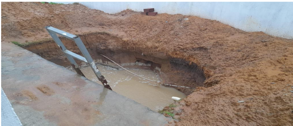
Foto 02 – Desmoronamento de fossa séptica.
