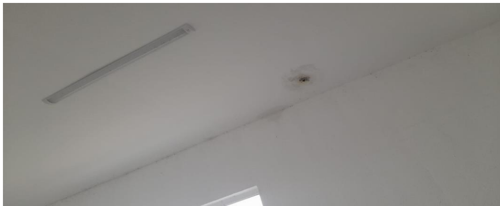
Foto 02 – Infiltração no forro.
