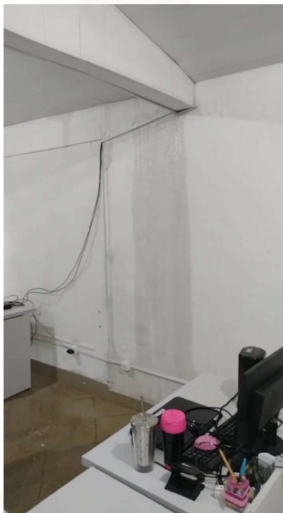
Foto 07 – Infiltrações de água da chuva causado pelo deslocamento das telhas
