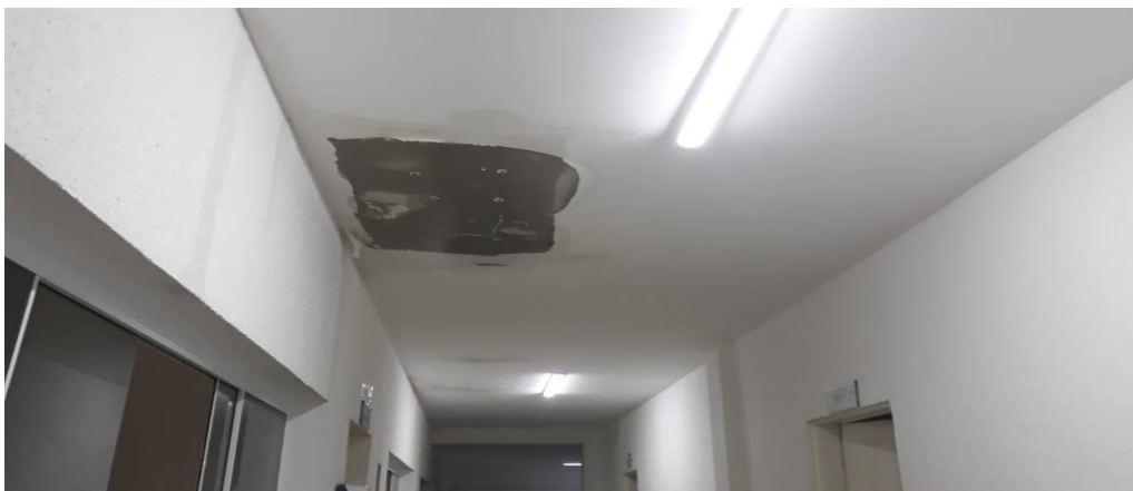
Foto 05 – Infiltração no forro.
