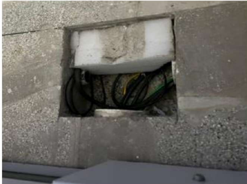
Foto 03 – vista parte elétrica no piso.
