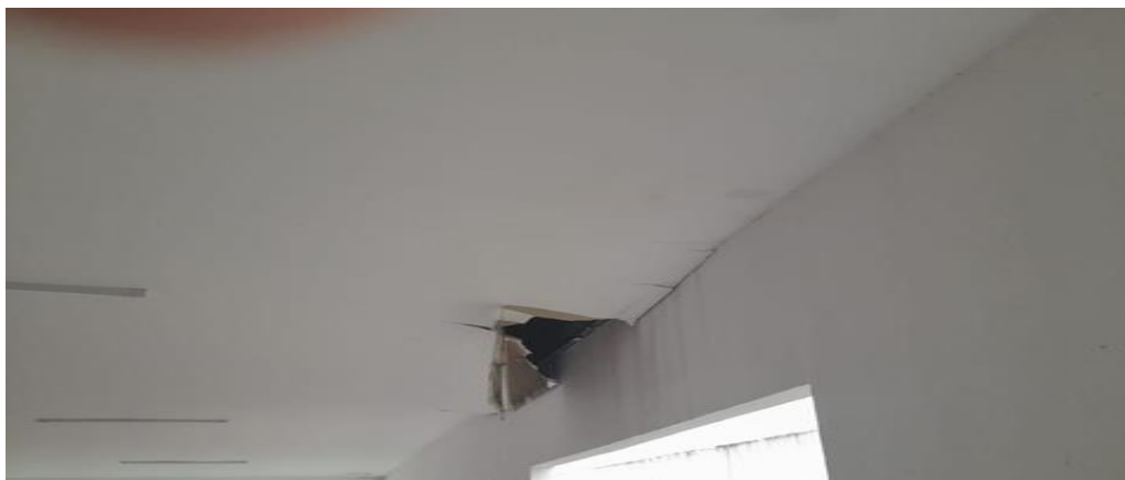
Foto 06 – Infiltração no forro.
