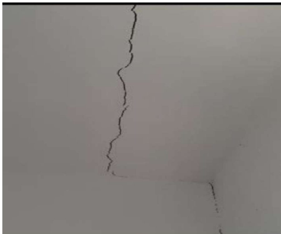
Foto 06 – vista de rachadura na laje atravessando a sala e seguindo para as salas vizinhas.
