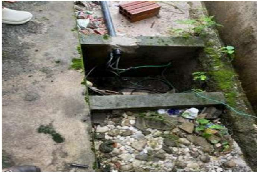
Figura 13 – vista das caixas elétricas do piso, na área externa recebendo toda água pluvial, passando pelas calhas para demais caixas.
