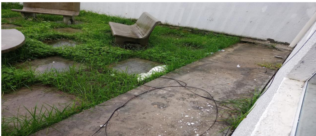
Foto 08 – Afundamento de calçada.
