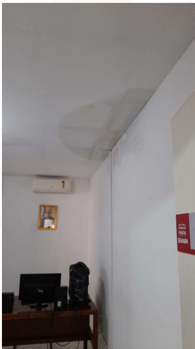
Foto 05 – Infiltrações de água da chuva nos forros de gesso
