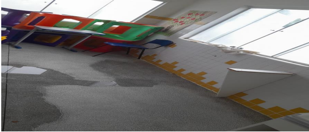
Foto 04 – Infiltração na esquadria de alumínio e vidro.
