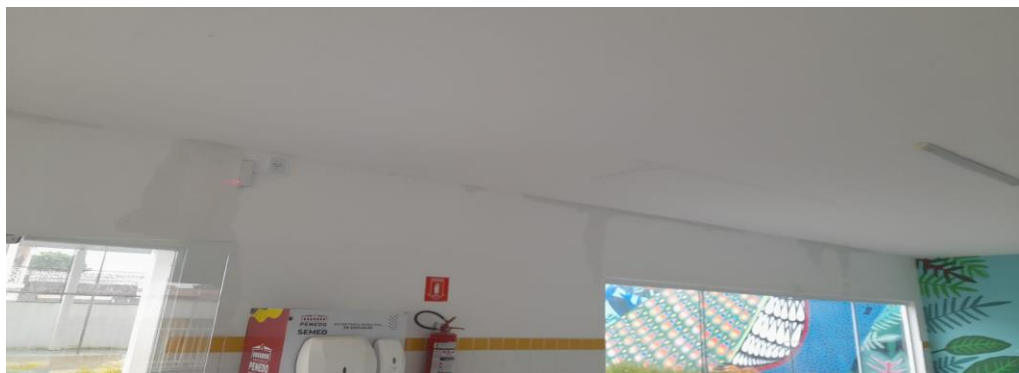
Foto 03 – Infiltração no forro.
