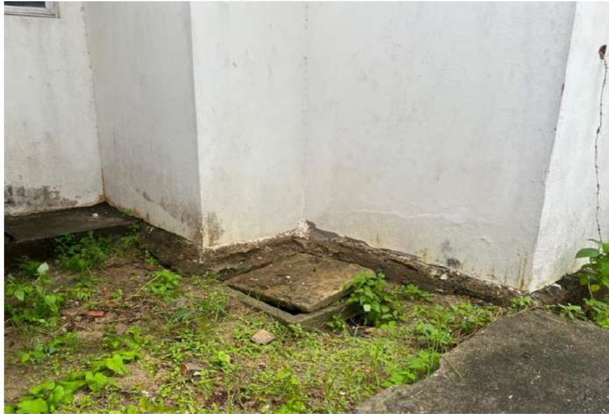
Foto 05 – vista para área externa, com o pé da parede sem proteção.
