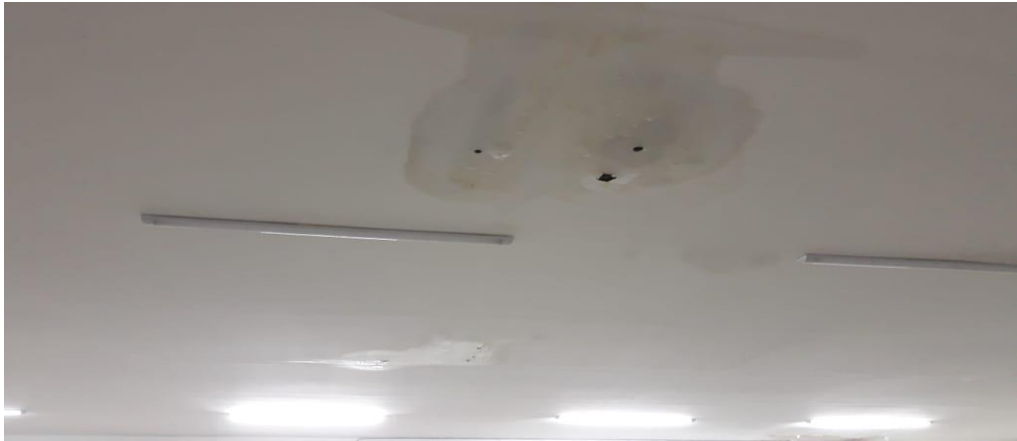
Foto 06 – Infiltração no forro.
