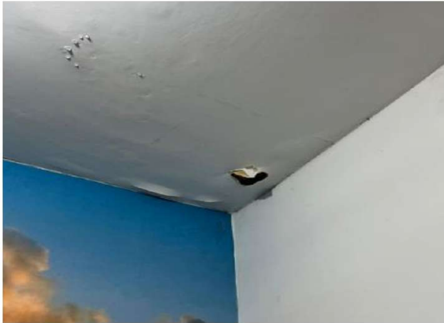
Foto 01 – vista de infiltração no teto.
