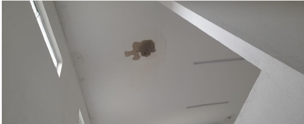
Foto 01 – Infiltração no foro.
