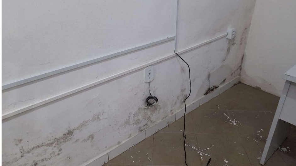
Foto 01 – Umidade na Alvenaria com fungos
