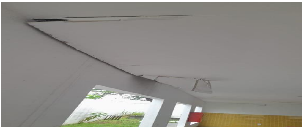
Foto 05 – Infiltração no forro.
