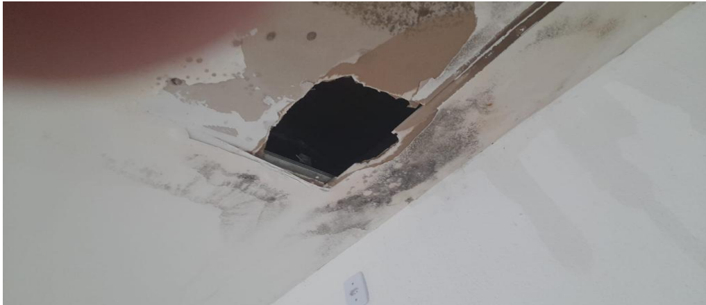
Foto 07 – Infiltração no forro.
