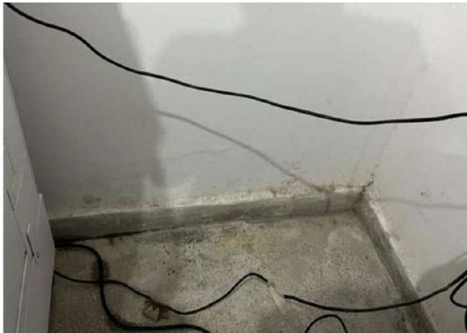
Figura 10 – vista da parede com umidade vindo do piso.
