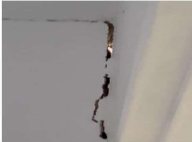
Foto 07 – vista de rachadura parede onde já é possível passar luz vento e água.
