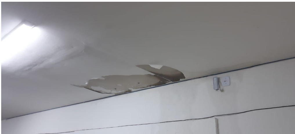
Foto 07 – Infiltração no forro.
