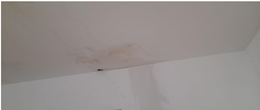
Foto 03 – Infiltração no forro
